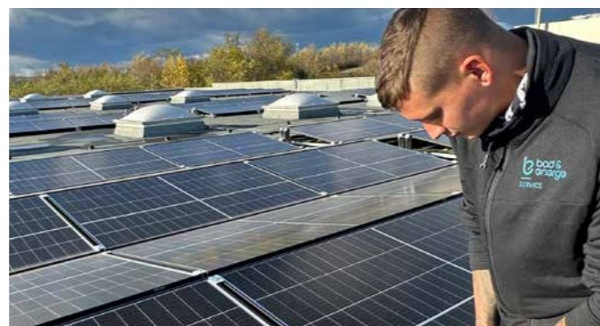
Höchste Ausbeute realisieren: Photovoltaik
